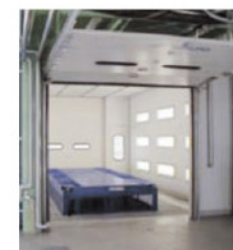
ピット内リフター& オーバースライダードア
